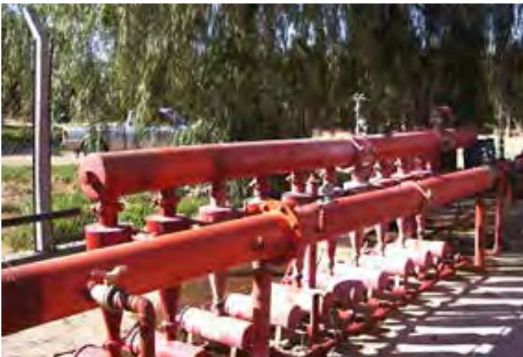
Stazione di filtraggio di acqua di pozzo con filtri centrifughi montati in batteria
